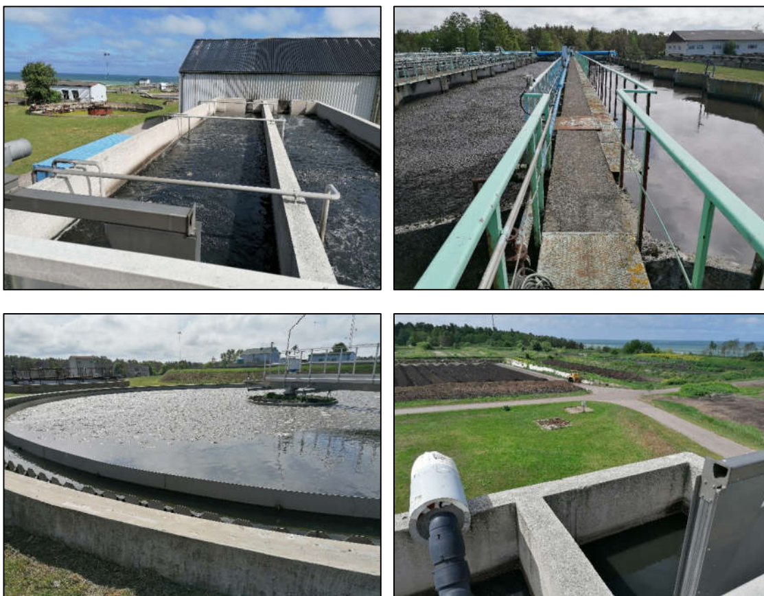
15 pav: Liepojos nuotekų valymo įrenginių fotografacijos per mokomąją kelionę MEDWwater projekto apimtyje. Aeracijos baseinas prieš neapdorotų nuotekų atranką (H 2 S neutralizavimo priemonė) su fone matoma Baltijos jūros dalimi (viršuje kairėje), biologinio valymo etapas su nitrifikacija / denitrifikacija (viršuje dešinėje), antrinis nusodintuvas (apačioje kairėje), nusausinto perteklinio dumblo džiovinimas ir saugojimas (apačioje dešinėje).
